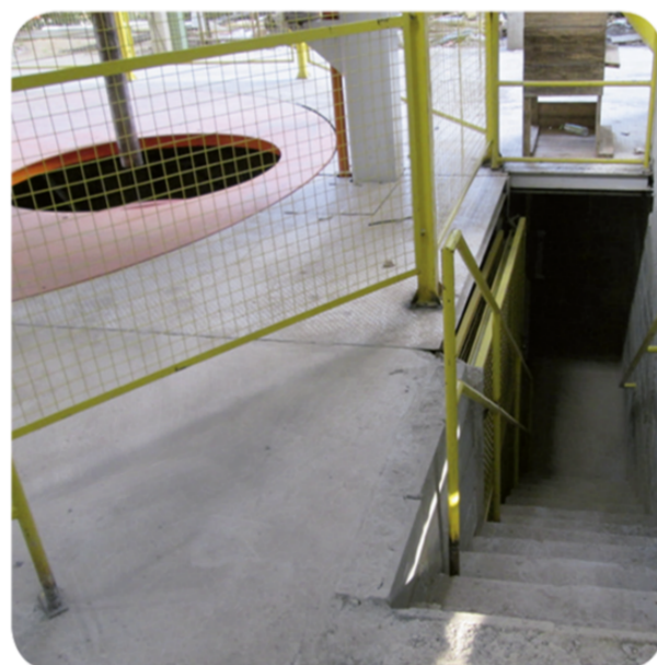
Estrutura de acesso ao fosso. Structure for accessing the cesspit. Estructura de acceso al foso.
